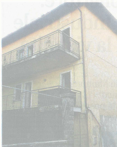
Da riqualificare. La palazzina fatiscente ex Eca in Via Gasparo
